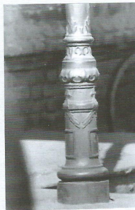
Нижняя часть колонны крыльца здания, заведующего завода в Белой Холунице. Литьё, Конец
